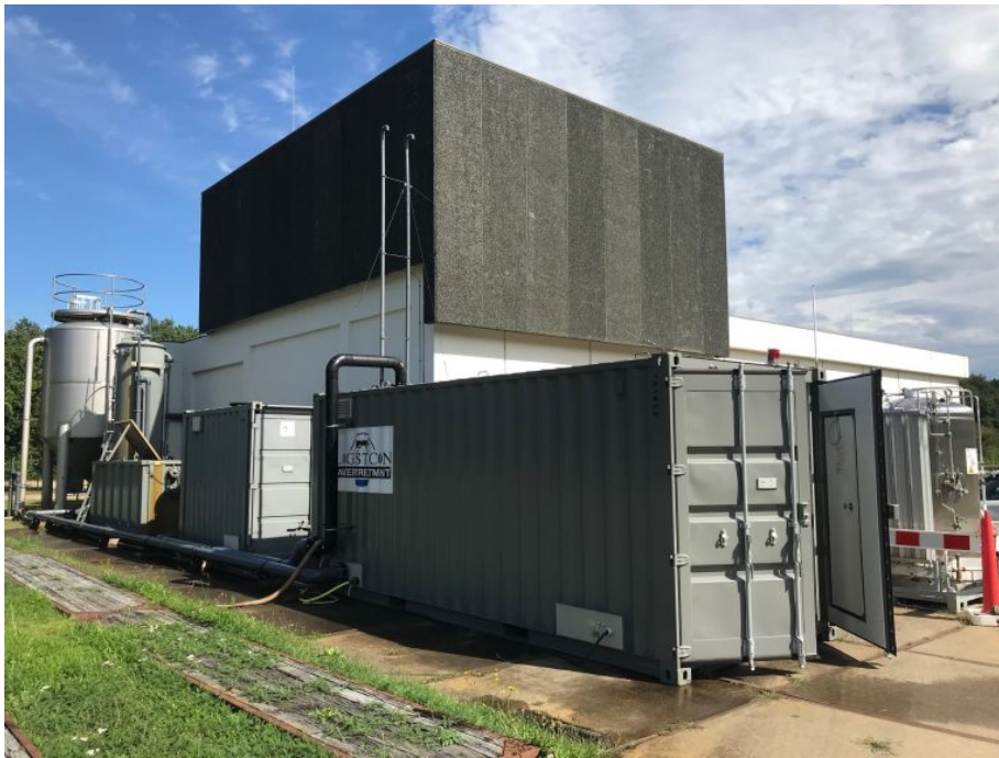
Proefinstallatie (membraan)vacuümontgassing productielocatie Sellingen
